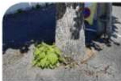
Par manque de place, les racines font éclater l'enrobé pour se développer.
